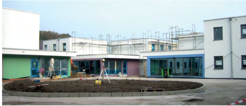
Baustelle Asylbewerberheim Rohwiesen in Wolfsburg. 245 Wohnplätze entstanden als kleines Ensemble rund um den zentralen Platz, der als wichtiges integratives Element angesehen werden kann, Foto: Stadt Wolfsburg, 2015
